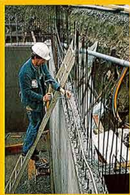
Stortnaden bij de aansluiting van vloer en wand
