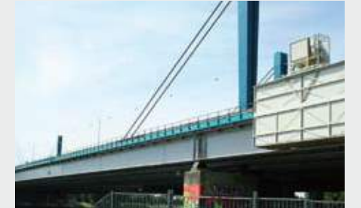
Bij de Utrechtse Galecopperbrug is er eigenlijk alleen vermoeiingsschade ter plaatse van de wielsporen van de rijstrook van het vrachtverkeer.
